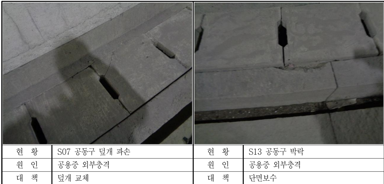
【사진 2.3.9】 공동구 및 배수시설 손상현황
